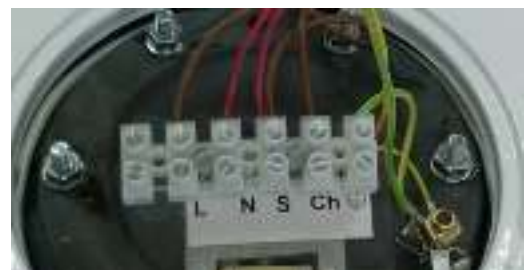
Рис. 3 Фото. Колодка подключения встроенного термостата бойлера STOUT.
